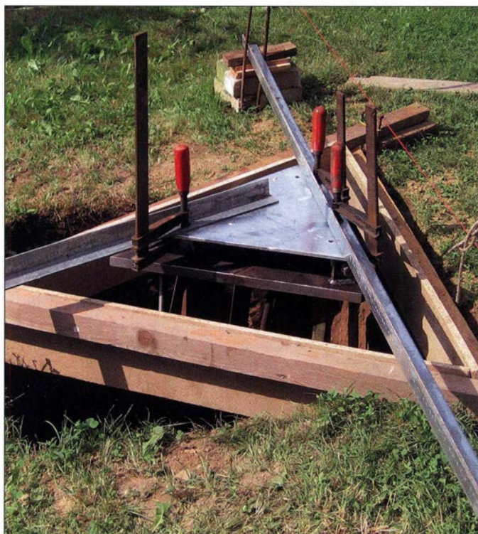
Bild 1: Schalung und Fixierung der Unterkonstruktion vor dem Betonieren; die Schalung lässt aus dem quadratischen Loch im Oberteil ein gefälligeres Dreieck heraussehen. Ferner sind Teile der an der Unterplatte angeschweißten Bewehrung erkennbar. Das Ganze wird mit Klötzchen so gerichtet, dass die untere Platte hinterher möglichst genau waagrecht und bündig in den Beton kommt. Das Fundament ist 1,2 m tief und hat unten 1,2 m x 1,2 m Fläche. Die Maße entsprechen kommerziellen Projekten vergleichbarer Größe.
